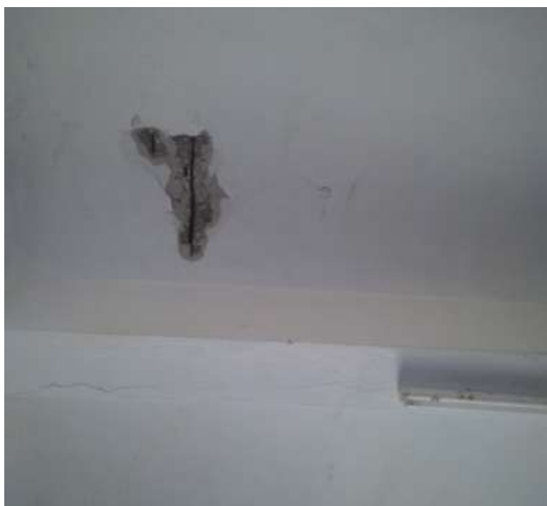
Φωτ.3 Διάβρωση της πλάκας σκυροδέματος
