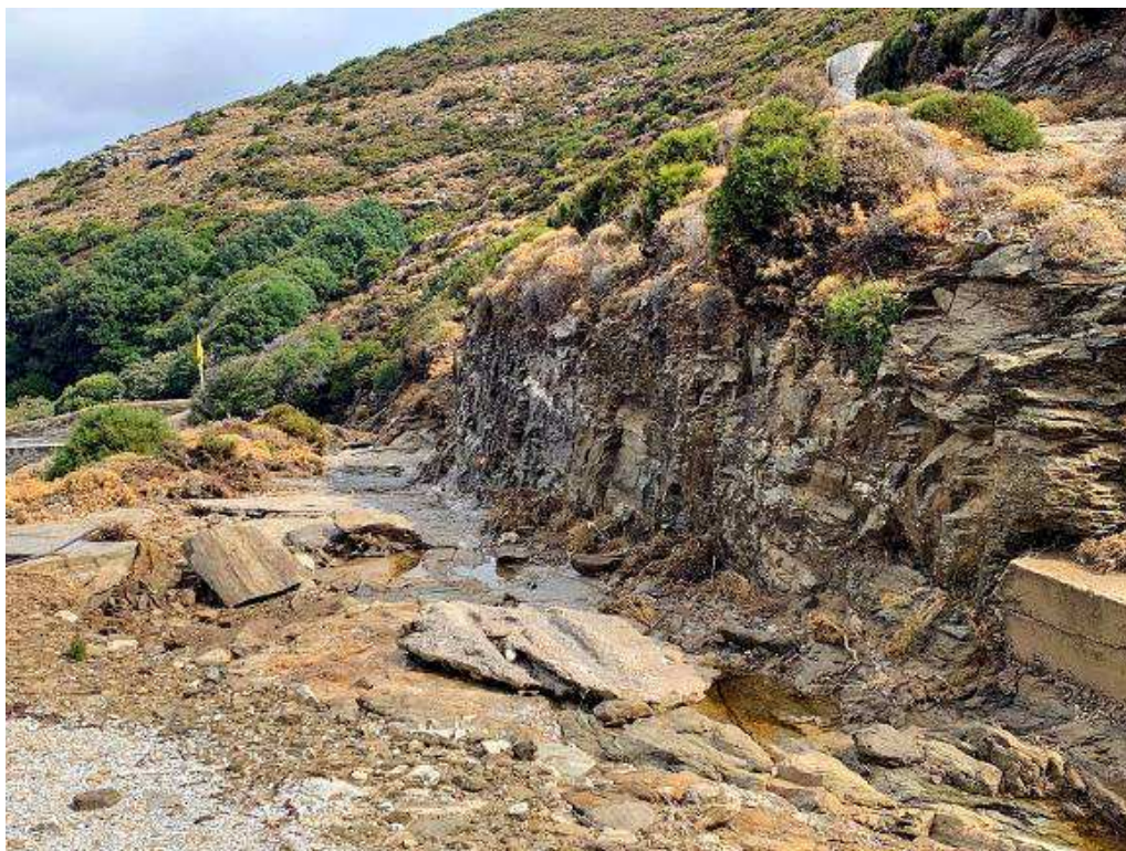
Ζημιές στην οδοποιία του νησιού
