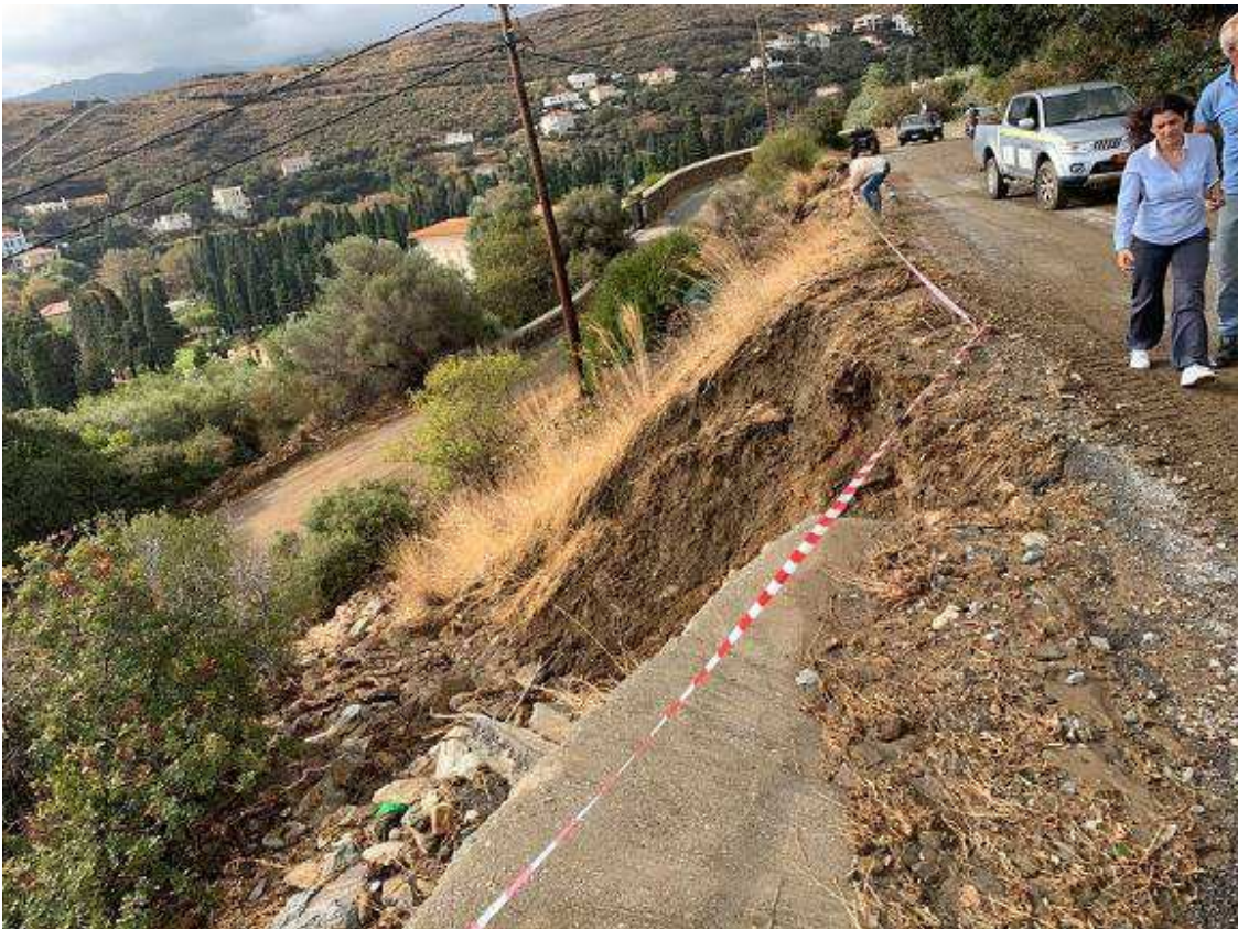
Φερτά υλικά και καταπτώσεις πρανών
