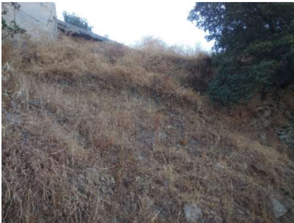
Σημείο 15. Αποκατάσταση τοιχίου αντιστήριξης σε δημοτική οδό στην περιοχή Νιώνα, στην Τοπ. Κοιν. Κορθίου
